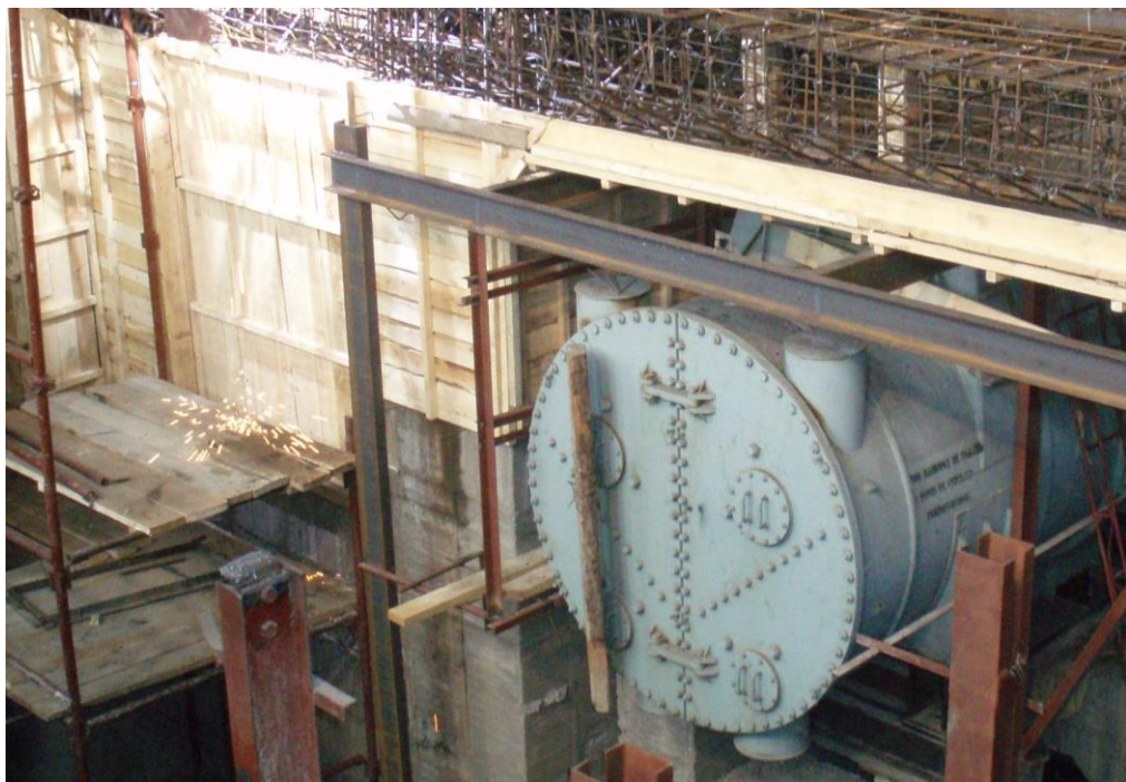
Конденсатор турбины и опалубка.
